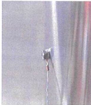
Installation d'une sonde Testo sur une cheminée
